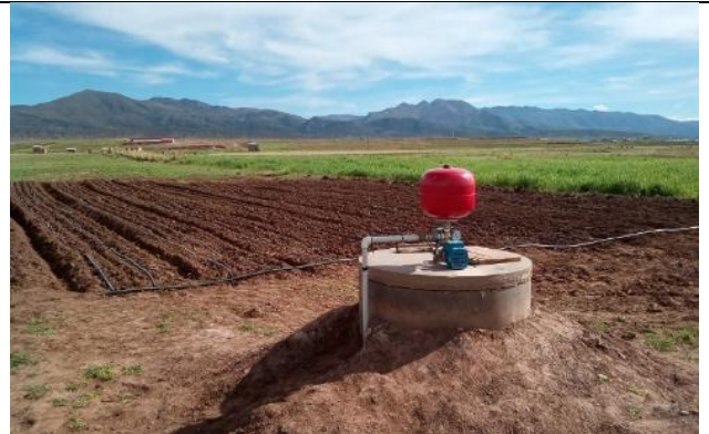
Parcela biointensiva con bombas automáticas y sistema de riego por goteo
