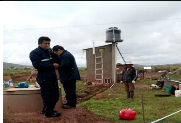
Instalación de bombas automáticas
